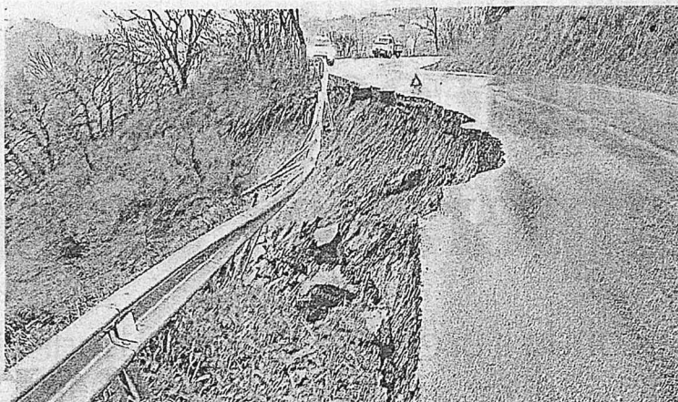
La frana sulla provinciale 30
